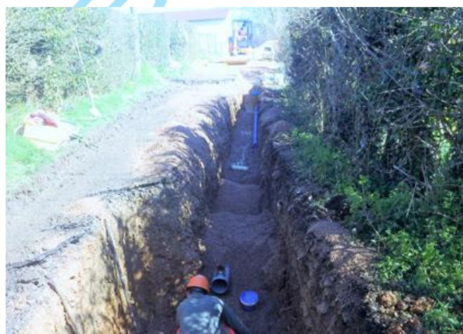
Pose d'une canalisation d'eau potable dans une tranchée recevant également une canalisation d'assainissement
