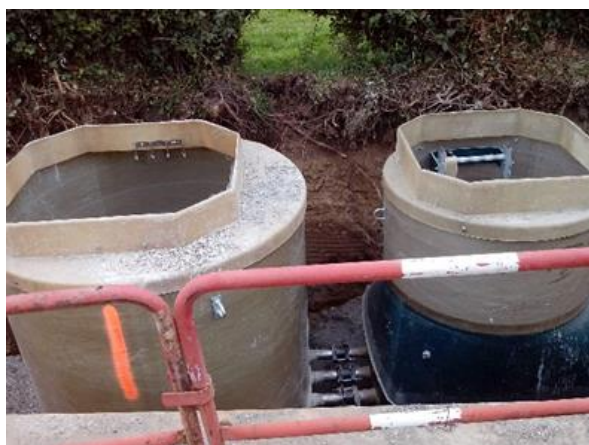
Poste d'un poste de refoulement sur réseau
