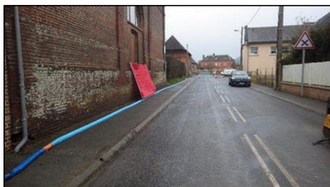
Pompage assurant la continuité du service
