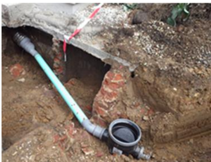
By-pass d'une ancienne fosse septique
